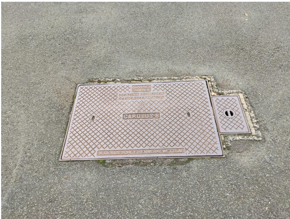
Foto 4: Leichtflüssigkeitsabscheider (LFA) vor Gebäude IV
