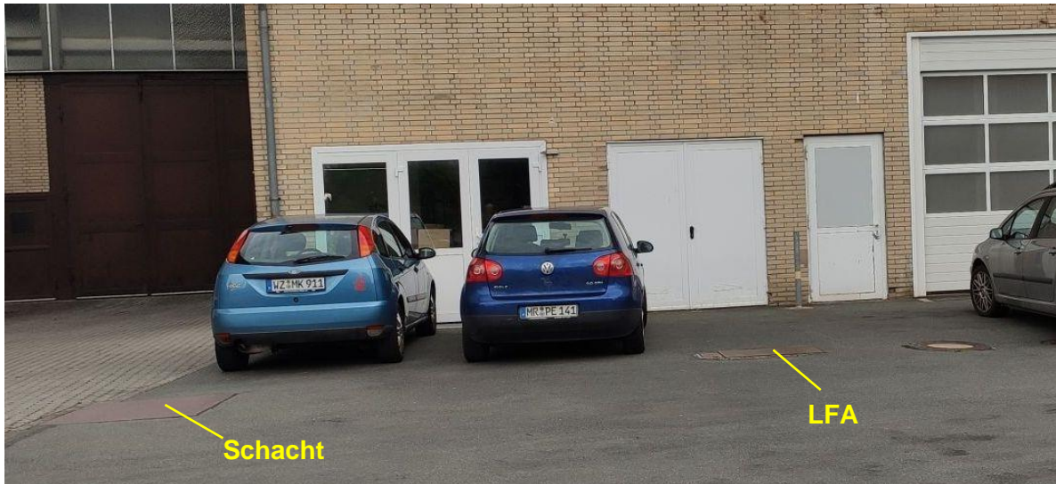
Foto 5: Leichtflüssigkeitsabscheider (LFA) vor Gebäude IV
