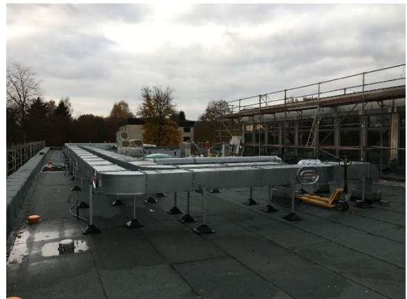
Lüftungskanäle auf dem Dach
