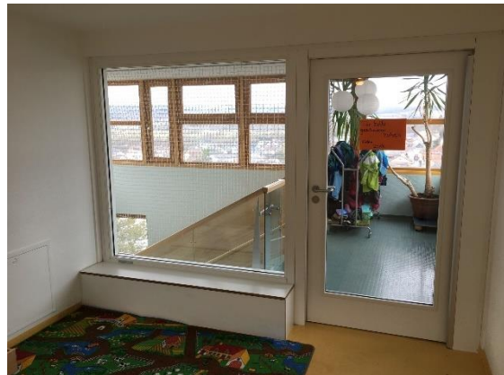
Brandschutztür zum Treppenhaus
